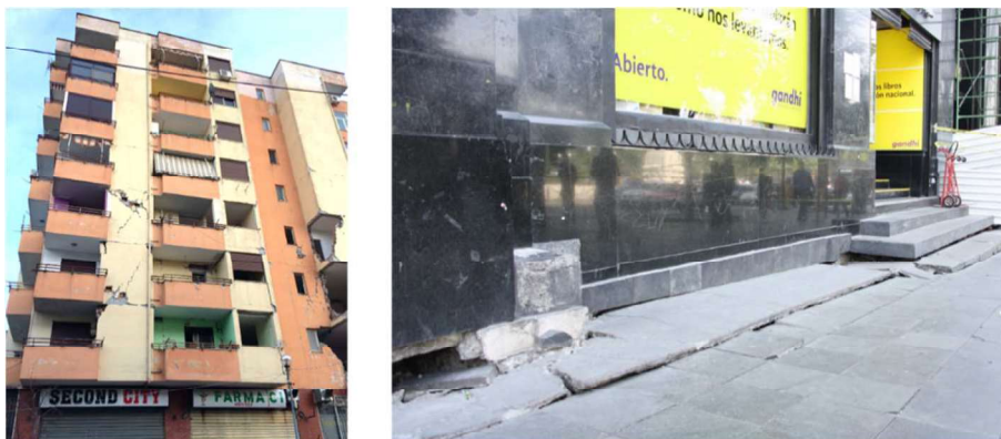
Figure 1. À gauche : relevé des désordres sur un bâtiment à 8 niveaux (séisme de Durrës du 26/11/2019). À droite : désordres à l'interface sol-ouvrage (séisme de Mexico du 19/09/2017).
